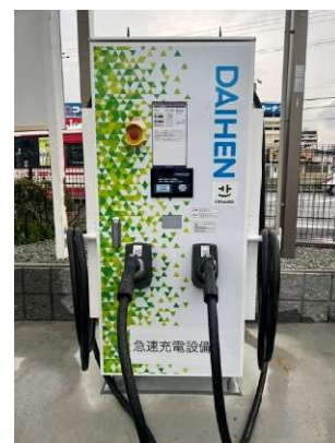
EV急速充電器
